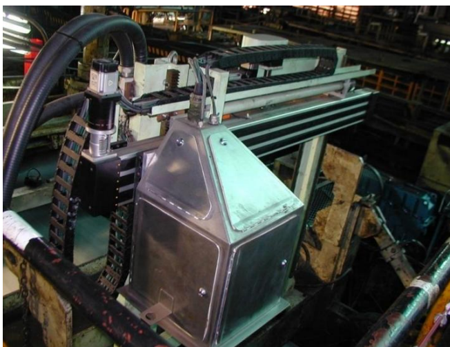
Servomecanismo y caja de inspección en línea de proceso (aproximación lateral)
