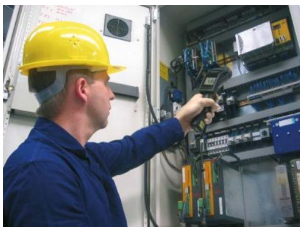
Detección rápida de puntos calientes en cuadro eléctrico
