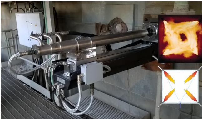
Vista de caldera en central térmica
