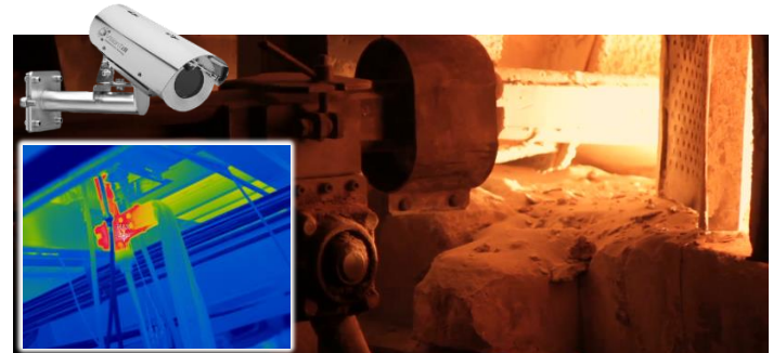
Control de fugas en horno de fusión de vidrio reciclado
