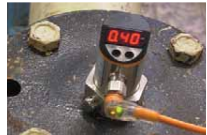
Visualización in situ: el display con LEDs con buena legibilidad muestra la presión actual del sistema.
